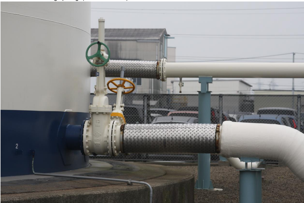
Figuur 14. Installatie van een flexibele stalen buis, aangesloten op een groot olietank, die een beweging van zowel tank als leiding opvangt (Foto: A.M. Cruz)
