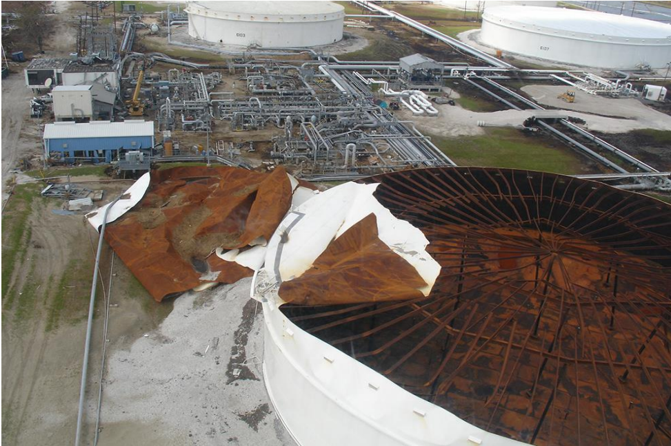
Figuur 8. Schade aan het vaste dak van een atmosferische opslagvat veroorzaakt door sterk wind (Bron: NOAA)
