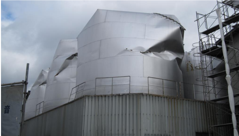
Figuur 4. Knikschade vanwege aardbeving bij silo's (Foto: E. Krausmann)
