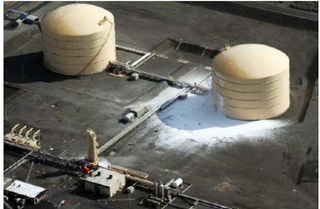
Figuur 2. Luchtfoto genomen kort na de storing. Branden nog zichtbaar. Lekkage van perliet-isolatiemateriaal uit de doorboorde buitenmantel van de LNG-1 opslagtank. Controlekamer linksonder. (PHMSA, 2016)
