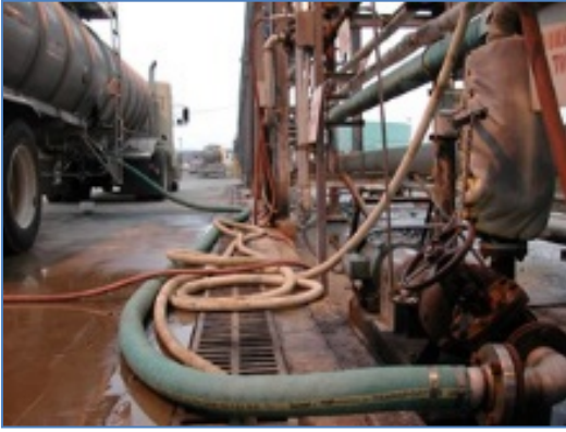
Figuur 3: Afvoerput bij het tankwagenlaadstation (bron: CSB)
