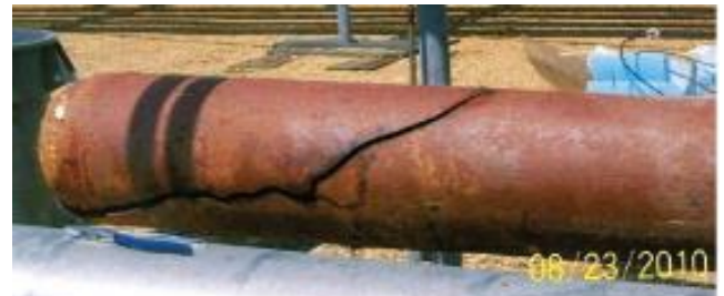
Figuur 5. Gebroken eindkap met een diameter van 12 inch van een lage-temperatuur-aanzuigleiding op het dak van het gebouw.
