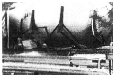
3月11日15時15分頃 水張り中の貯槽が座屈
