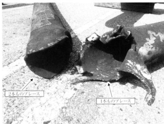
写真7 破断したブレース交差部 (その2)
